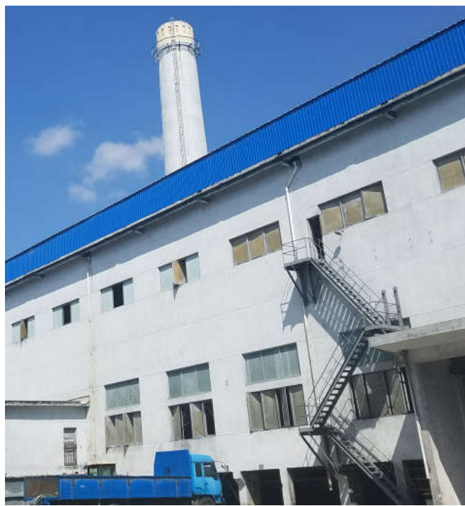
70m 电解车间烟囱（废气排放口）
