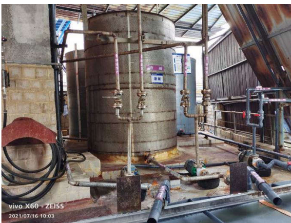
污水处理一站盐罐区
