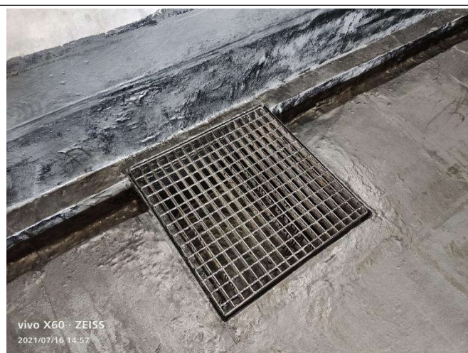
危险储存间泄漏收集池
