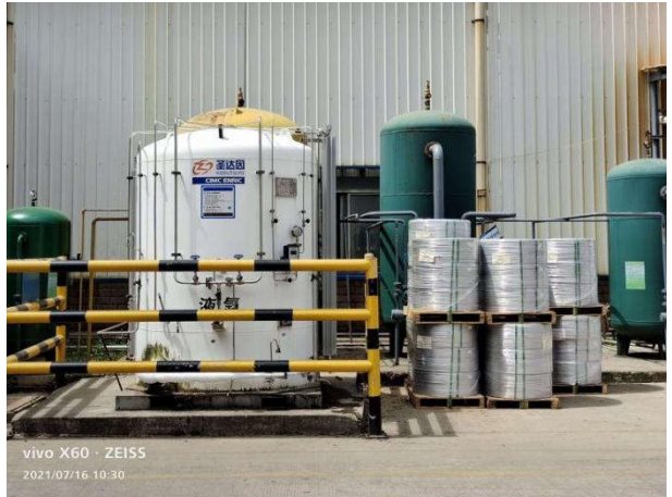
华银厂区氩气储罐
