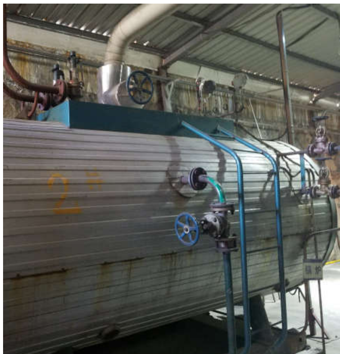
锅炉及仪表监控
