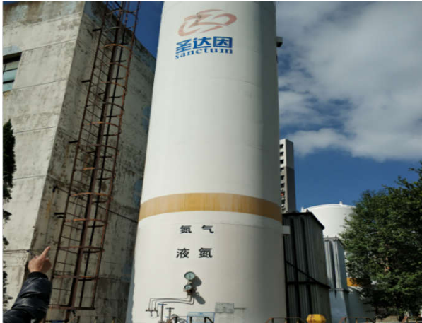
化工库北侧液氮储罐
