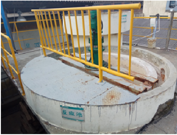
华银污水处理站反应池
