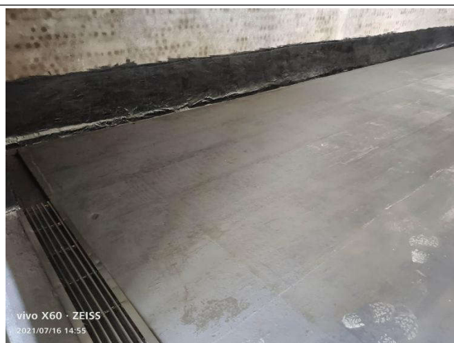
危险储存间导流沟
