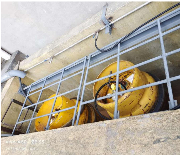
模具车间液氨存地下储槽
