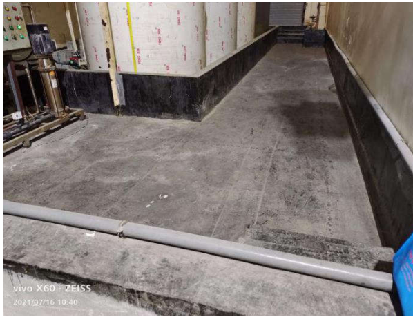
华银氧化车间罐区围堰及防渗
