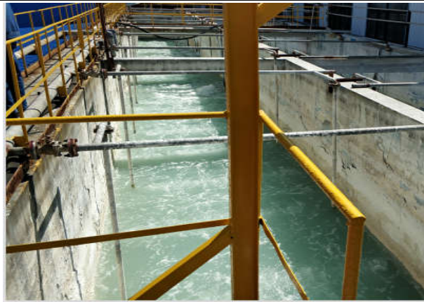
污水处理一站调节池
