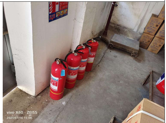
油漆储存间消防设施
