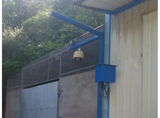
厂区视频监控
