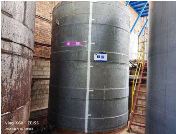
污水处理一站硫酸罐
