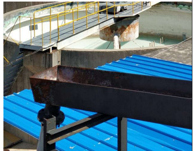
污水处理一站事故应急池（452m 3 废水浓缩池）
