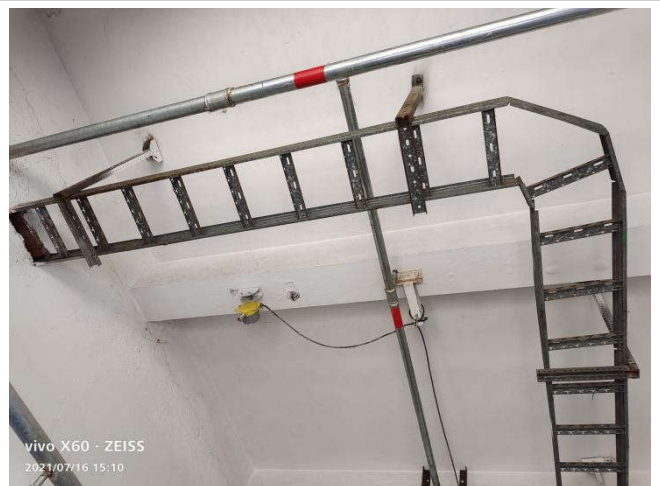
液氨瓶储存间探测器
