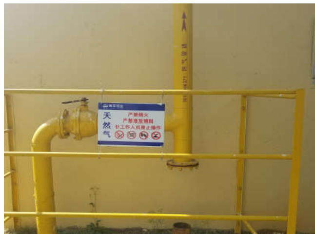
天然气管道及警示标志
