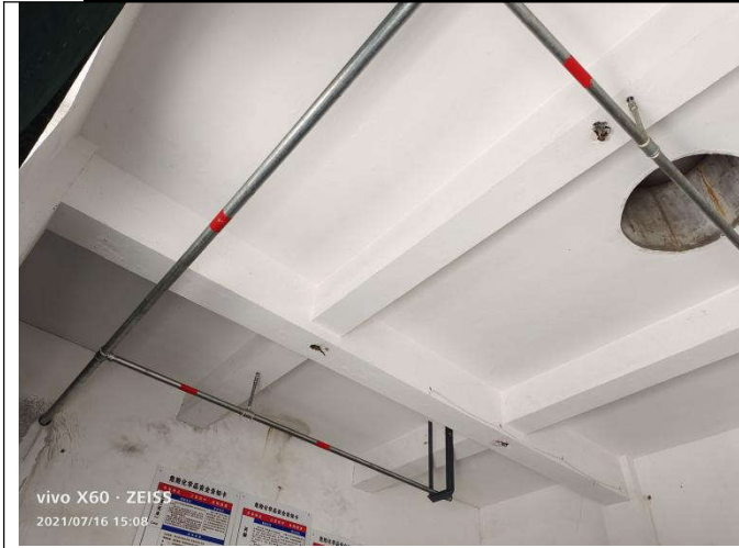
液氨瓶储存间喷淋设施
