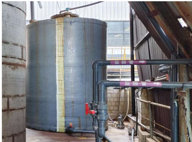
污水处理一站液碱罐
