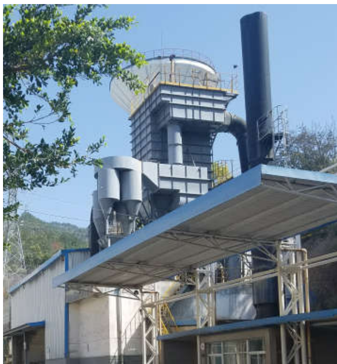
铝渣废气除尘系统
