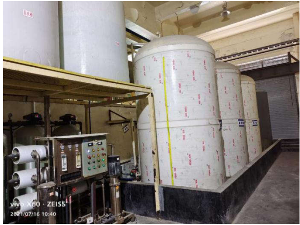
华银氧化车间液碱罐
