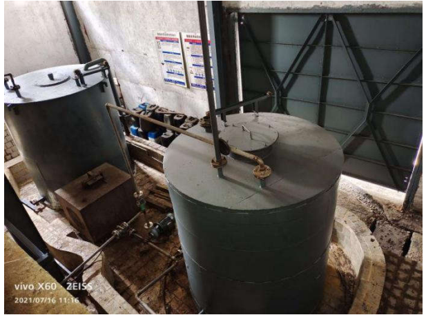
污水处理二站硫酸罐和液碱罐
