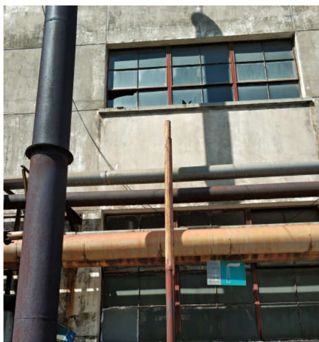
锅炉烟囱废气排放口
